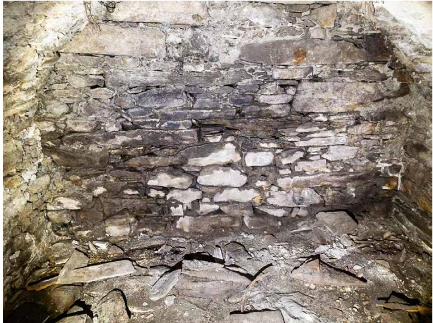
24.10.2022 – UG – Nördliche Rückwand mit Wassereinschlüssen
