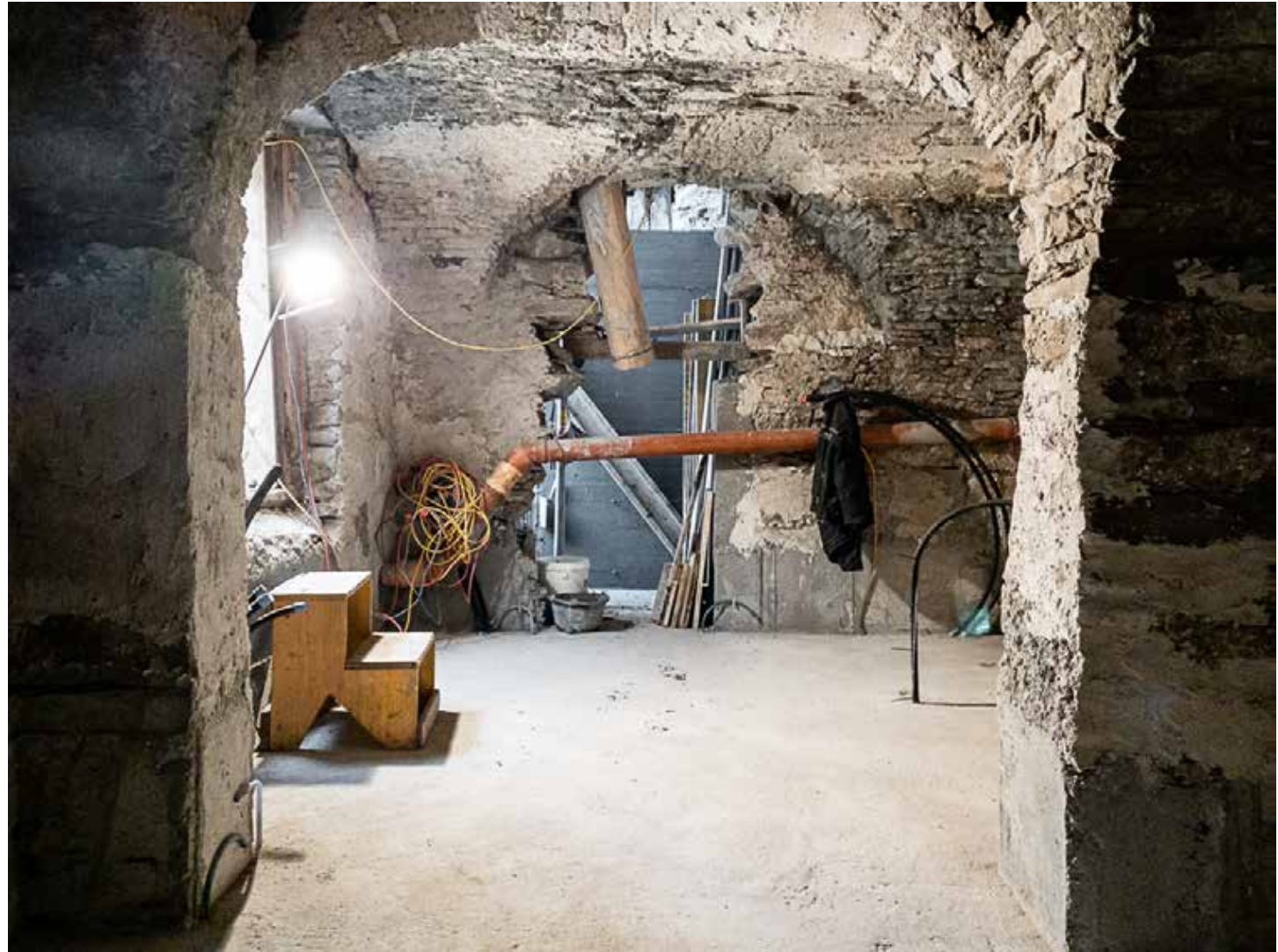
09.12.2022 – UG – Provisorische, kommunale Fäkalleitung durch das Haus
